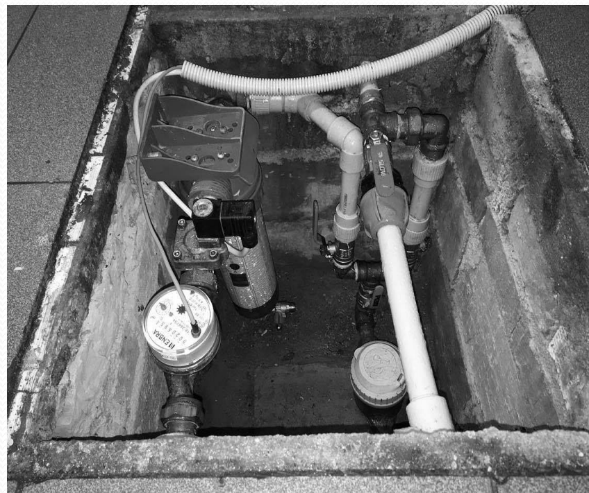
Hydrostop umístěný v šachtě společně s filtrem nečistot a bypassem.
